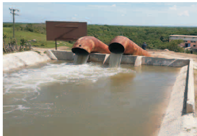
El Polo Productivo El Vaquero es uno de los que se beneficia con el agua de la Estación de Bombeo con casi sus 324 hectáreas bajo riego, sin necesidad de emplear combustible
