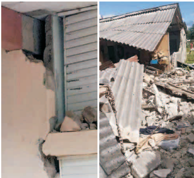
Las severas afectaciones en viviendas por los sismos de noviembre confirman lo imprescindible de cumplir con la Norma cubana para construcciones sismorresistentes Fotos: Orlando Amaro
