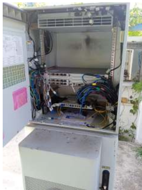
El vandalismo también ha llegado a las radiobases, principalmente teniendo como objetivo el robo de las baterías, que garantizan el servicio telefónico
