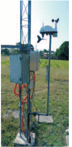
Estación automática dañada por descarga eléctrica
